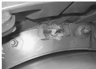
图 3 定子槽楔拉紧器固定 螺栓断裂
