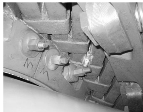
图 4 定子槽楔拉紧器固定 螺栓掉落
