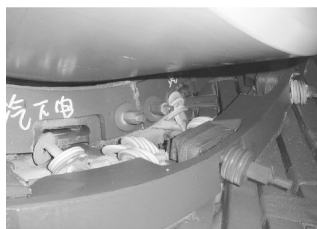
图 1 汽侧气隙隔板 螺丝局部松、断
