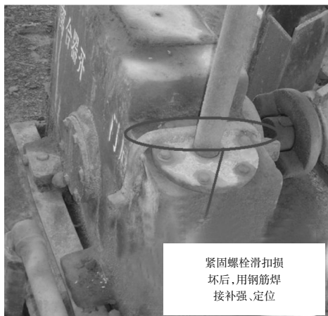
图 1 手轮转动轴轴承盖螺栓损坏
