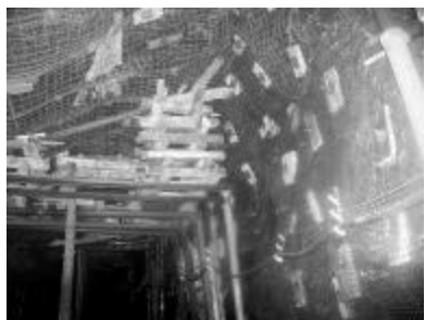
图 1 11201 风巷 1300m 处支护破坏情况
