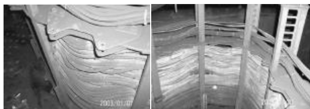
图 1 托盘结构及电缆磨损情况
