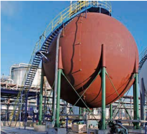
二氧化碳捕捉和封存(CCS)示范项目
